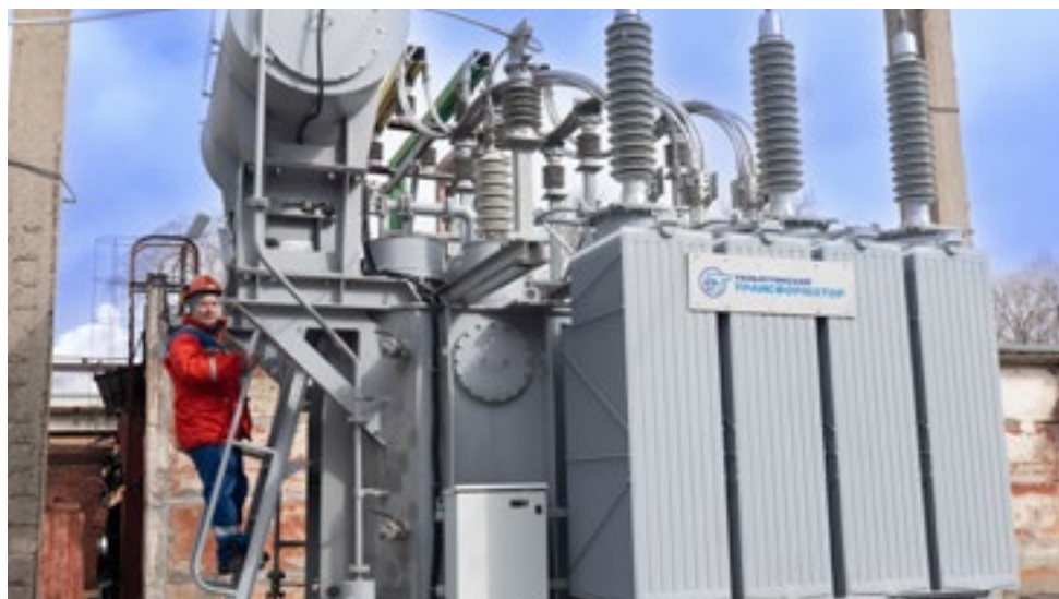
▲ Новые трансформаторы надёжны, более энергоэффективны и требуют гораздо меньше ресурсов при обслуживании
