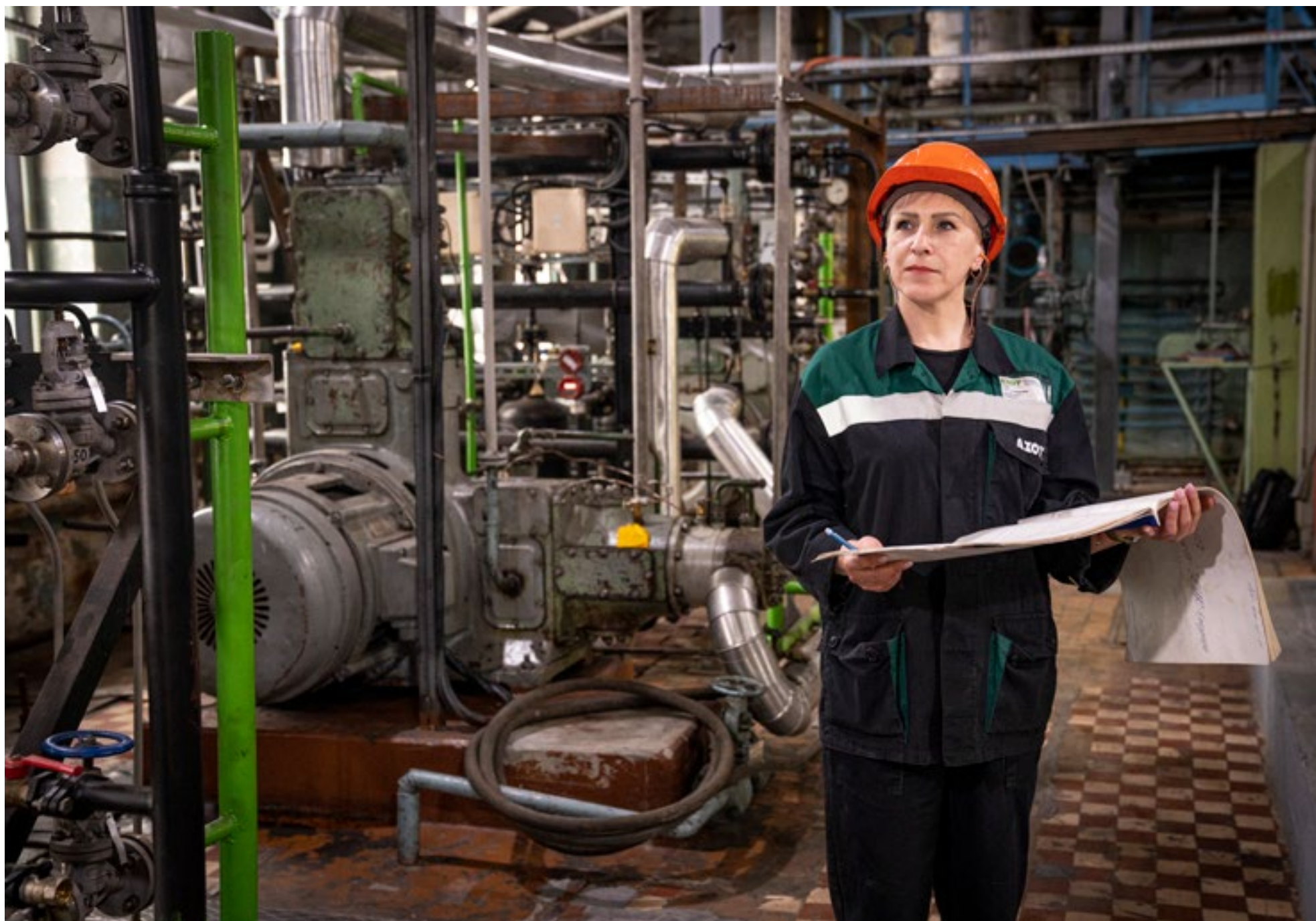
▲ Наталья Юдина, аппаратчик цеха газового сырья на обновлённом участке по производству жидкой углекислоты
