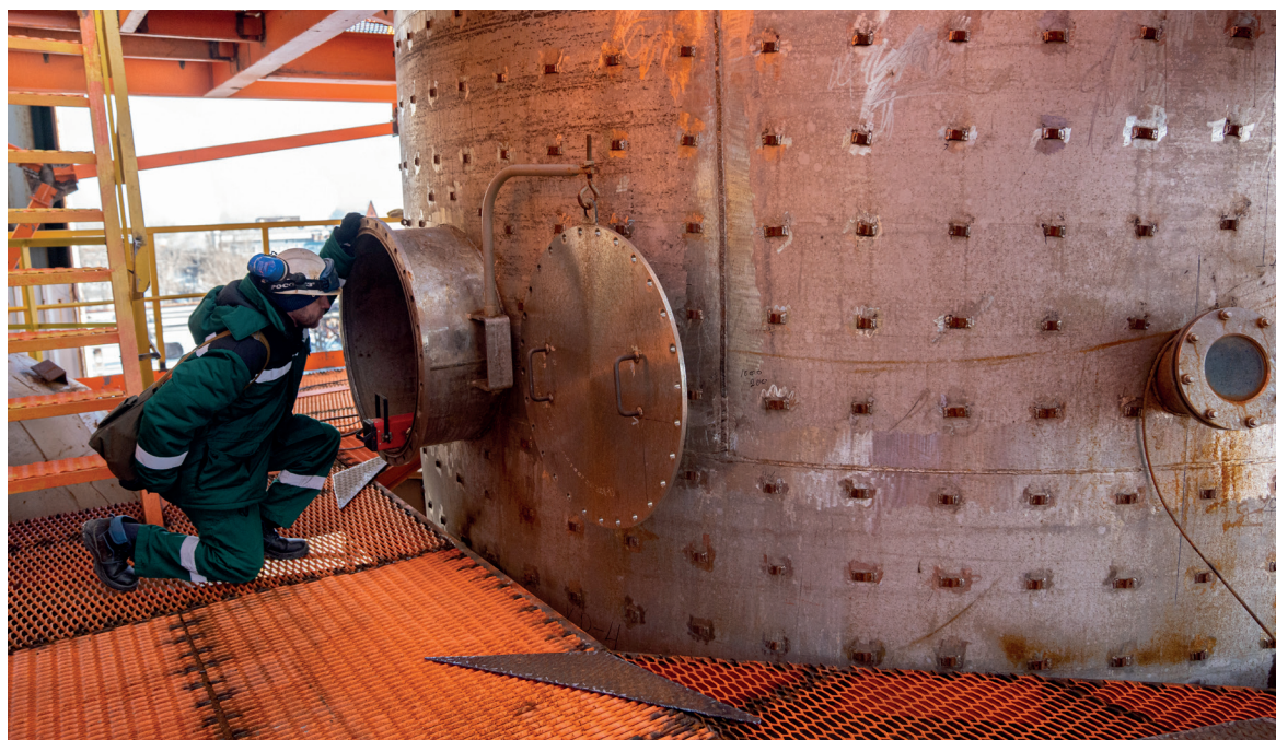
▲ На фото — лишь часть нового абсорбера, высота которого составляет 15 метров
