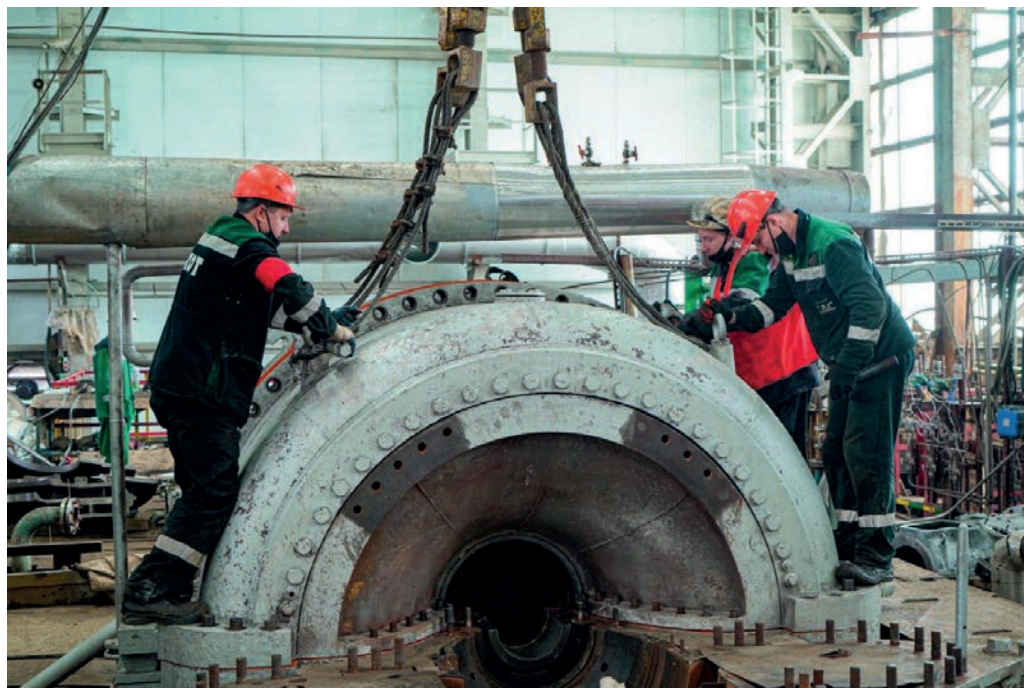
▲ Преобразование системы управления ремонтами и оптимизация расходов на обслуживание оборудования — важнейший шаг к повышению конкурентоспособности предприятия
