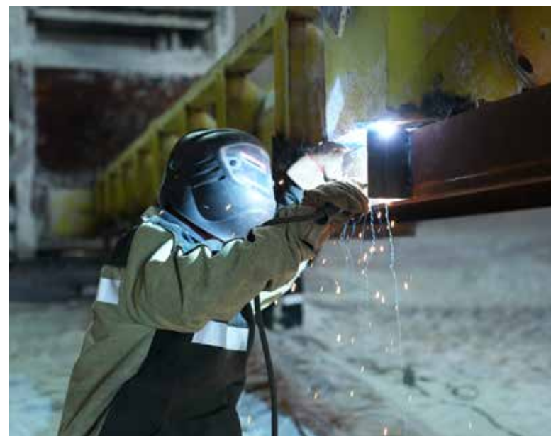
▲ Работы по замене скребковой цепи и направляющих на кратцер-кране в цехе сульфата аммония
